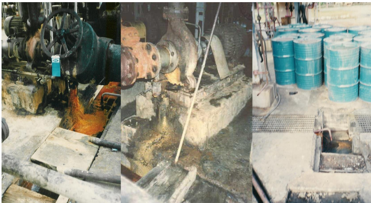
Figura 8 - Vazamentos constantes durante as operações industriais
