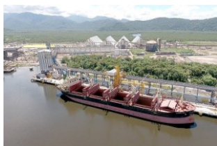
Cava subaquática integra o projeto de dragagem do canal de Piaçaguera e visa permitir o acesso de grandes navios aos terminais da VLI e também da Usiminas Foto: Divulgação/VLI
